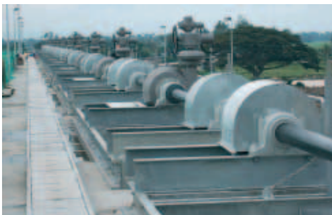
Bei einem Bewässerungsprojekt in Malaysia werden große durchdrehende GS Getriebe ohne Endanschläge eingesetzt. Mit der abgebildeten Anlage wird die Stellung der Wehrschütze geregelt.
