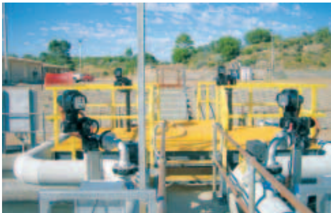
Drehantriebs-/Schneckengetriebe Kombination in einer Wasseraufbereitungsanlage in Australien.
