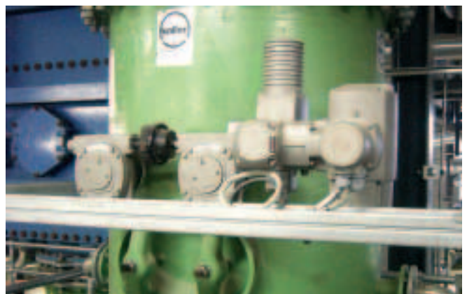
Eine ganz spezielle Lösung. Zwei hintereinander geschaltete GS Getriebe werden über einen gemeinsamen Drehantrieb betätigt, um eine Doppelklappe synchron zu verstellen.
